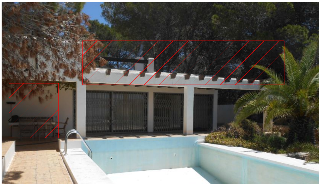
foto 2016: terraza tipo pérgola, muro ciego en la zona indicada en la izquierda de la fotografía
